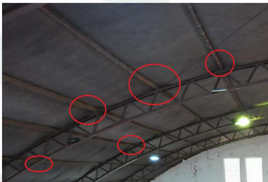
Imagem 22 - Corrosão presente em terças da cobertura
