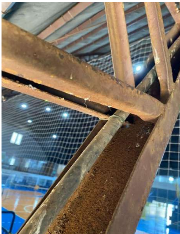
Imagem 21 - Corrosão presente em treliça
